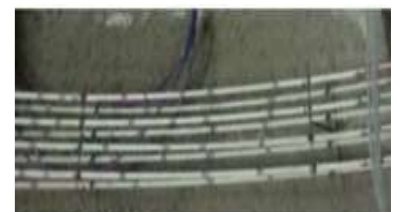
Figure 13 : Fibre optique source (ANDRA)
